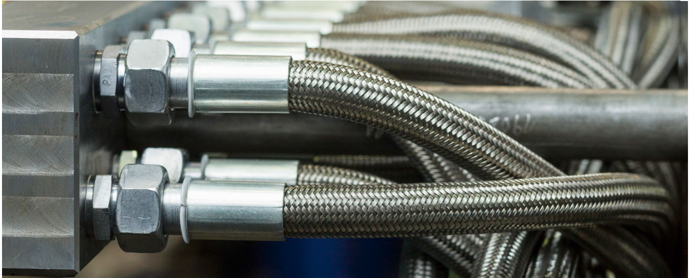
» Heck+Becker setzt fast durchgängig auf mehrfach verstärkte Teflonschläuche. » Heck+Becker relies almost throughout on multiple reinforced Teflon hoses.
